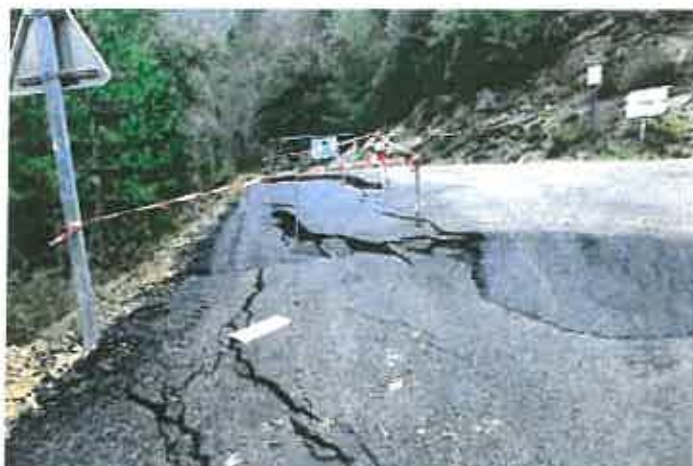
Vue de l'effondrement
